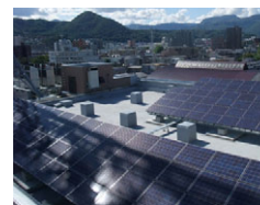
札幌西ビル屋上の太陽光発電パネル
